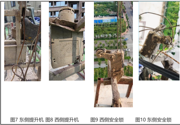
图7 东侧提升机 图8 西侧提升机 图9 西侧安全锁 图10 东侧安全锁
