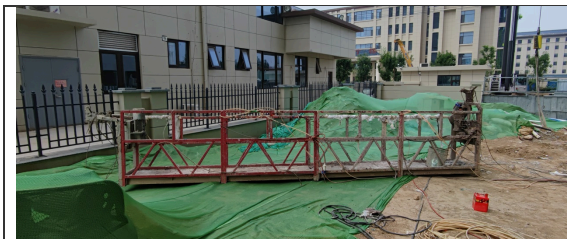
图3 事故吊篮外观
